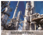
高温高压设备安全巡检
